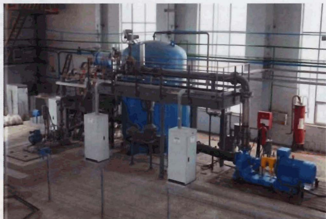
Стенд СИД 00.00.00 для испытаний и диагностики насосного оборудования
